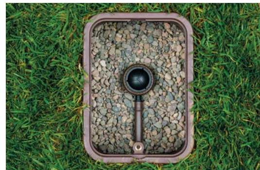
Automatisches Spülventil installiert
